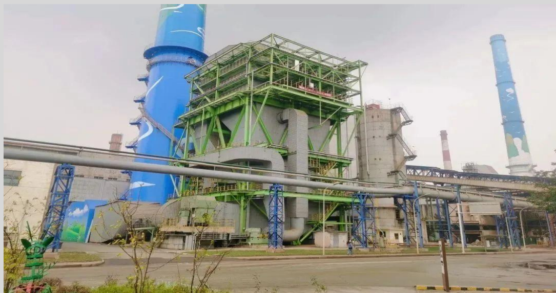
投运的脱硫脱硝设备
