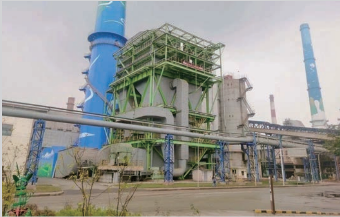
投運的脫硫脫硝設備
